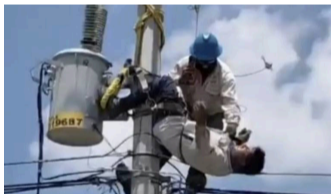
Trabajador recibe descarga eléctrica en poste de luz en Tlaxcala
