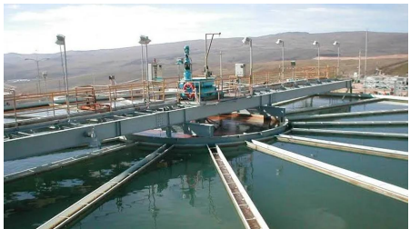
Instalación de tratamiento de agua con tanques y sistemas de purificación en zona desértica
