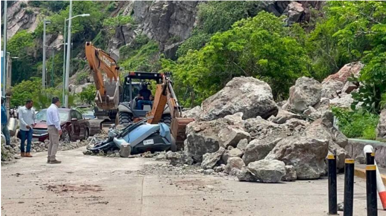
Derrumbe de rocas deja dos lesionados y provoca evacuación en el faro de Mazatlán
