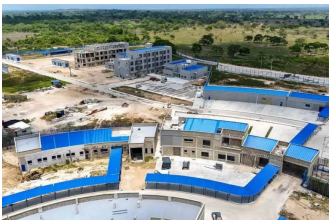
Colombia construirá una megacárcel como la de El Salvador
