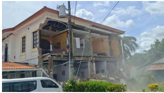
Afectaciones en la ciudad de Panamá tras fuerte terremoto
