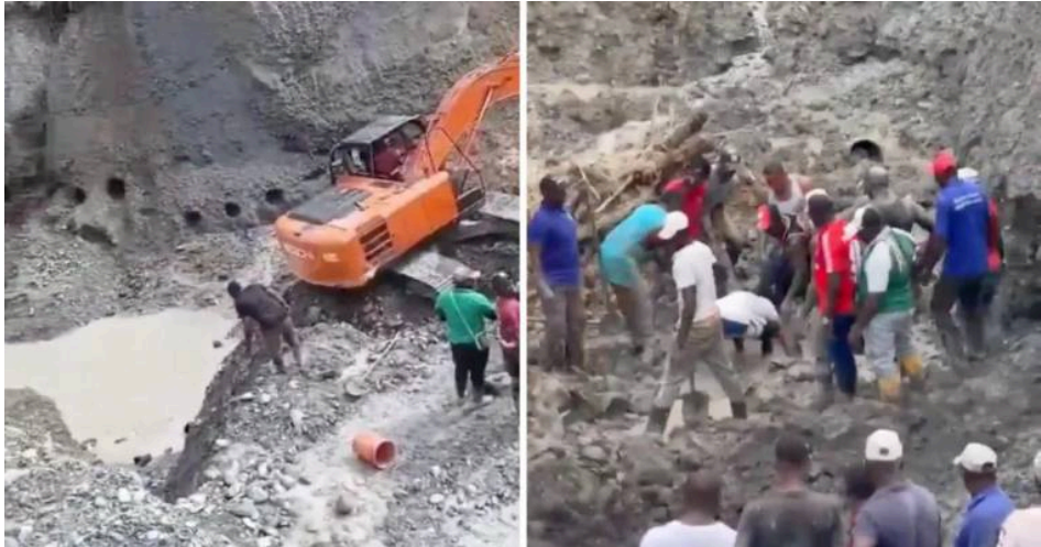
Derrumbe en mina de oro de Colombia deja nueve muertos y decenas atrapados
