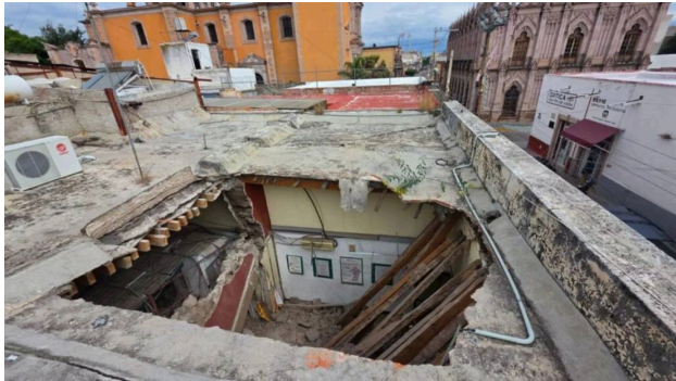
Colapsa techo de un Banco del Bienestar en Zacatecas
